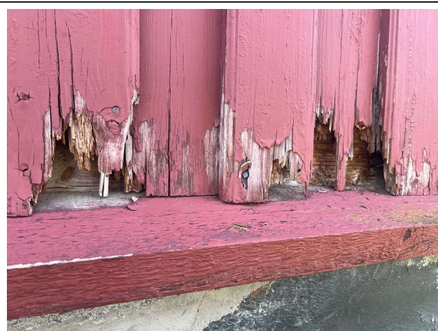
Kledning med råteskader ble beskrevet i overordnet forprosjekt i 2025, noe vi allerede var smertelig klar over
